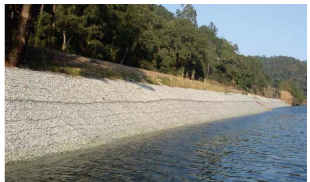
Figura 2. Gaviones para contención fluvial. Fuente:(A Bianchini, 2017).
